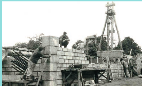
21 juin 1948 : Construction du massif d'ancrage, rive gauche, pose des pierres de parements et vue du chantier de bétonnage.
