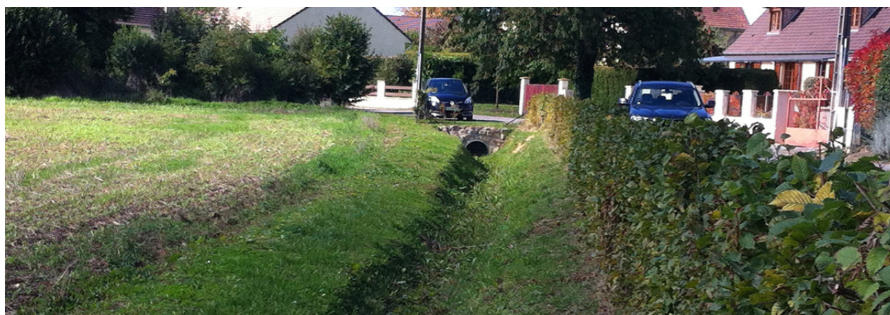
Fossé drainant aménagé chemin des Harnoulds.
